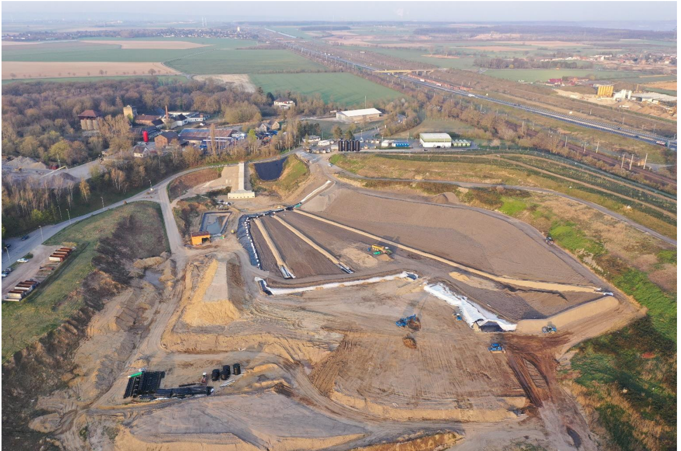
Luftbild der neu eröffneten Deponie „Haus Forst“ in Kerpen, © REMEX Mineralstoff GmbH
